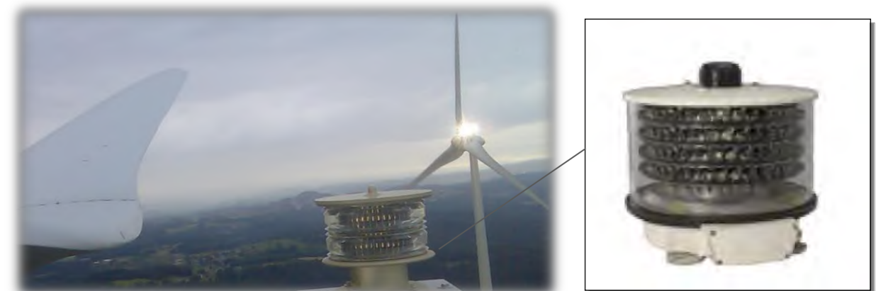
Figure 35 : Balisage d'une éolienne.
