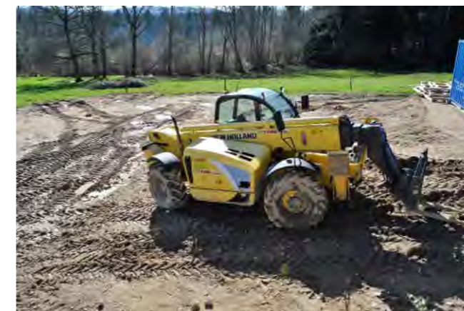
Photographie 56 : Exemple de tassement et d'ornières créés par les engins de chantier
