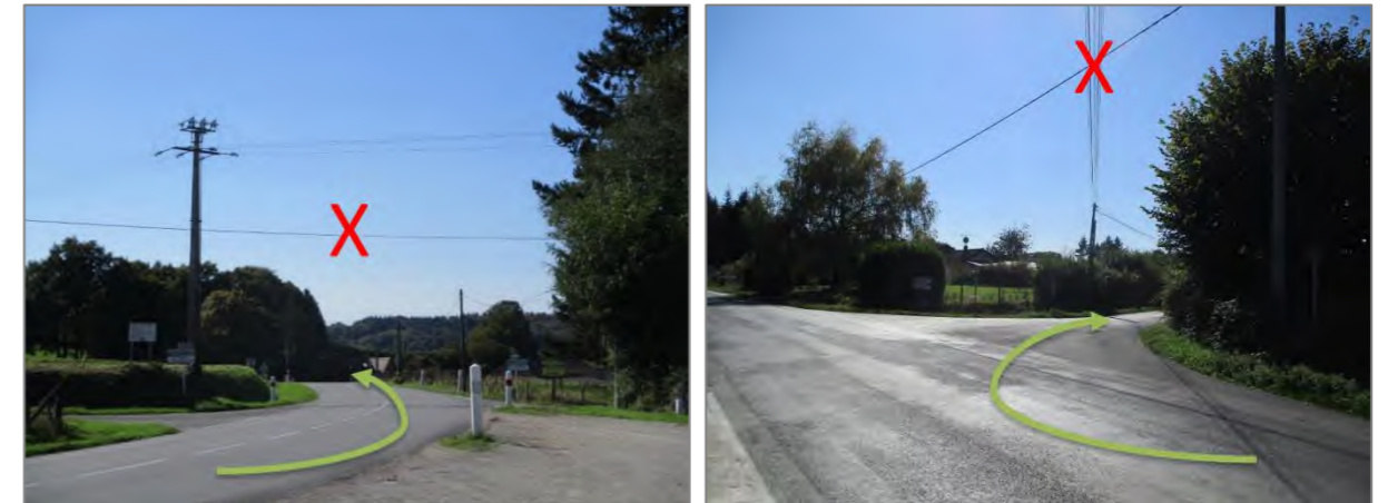
Photographie 48 : Dépose des lignes électriques et téléphoniques sur la D15 et la D17 (source : ENGIE Green)
